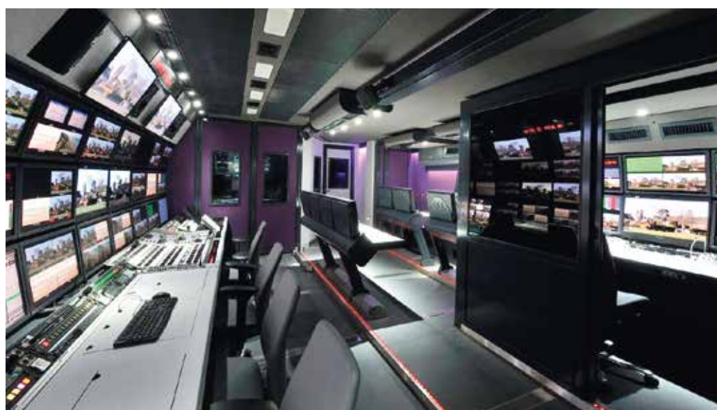
L'espace intérieur du Challenger de France 3 Toulouse
