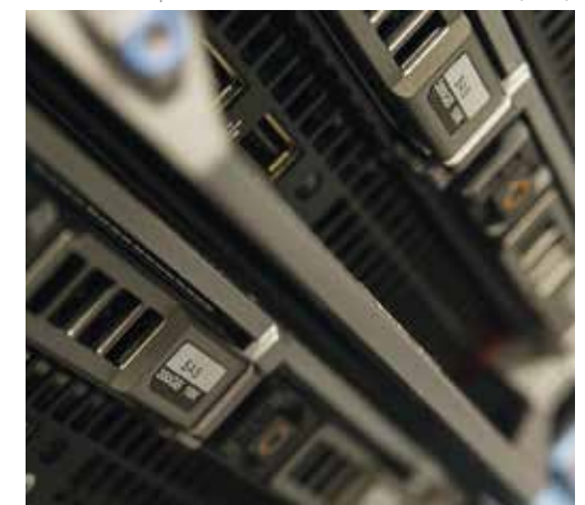
Les baies du proxicenter de Bordeaux Boulliac (TDF)
